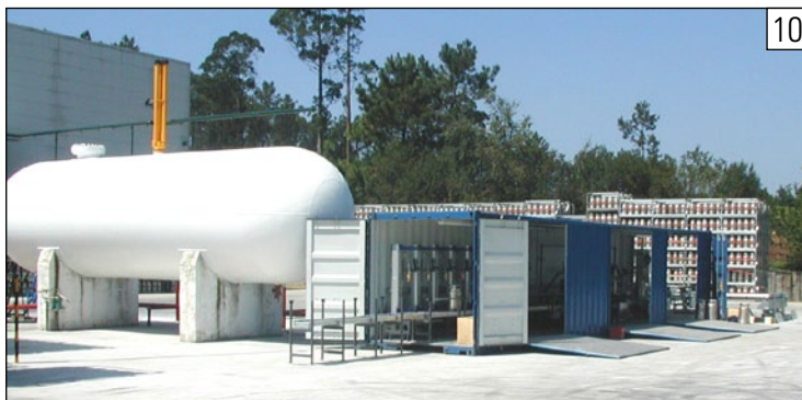
Planta de llenado en contenedor completa con tanque de almacenamiento
