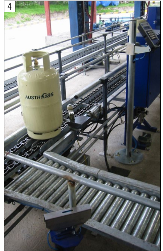
4 Sistema automático ECS de control del peso instalado en línea en transportador de cadena con transportador de rodillos para rechazo de cilindros mal-llenados
