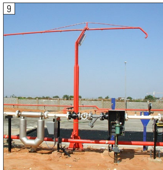
Sistema rociador en puntos de carga y descarga de camión-cisternas
