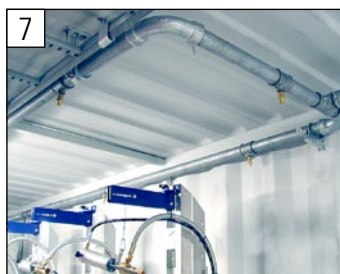
Sistema rociador integrado en planta de llenado en contenedor
