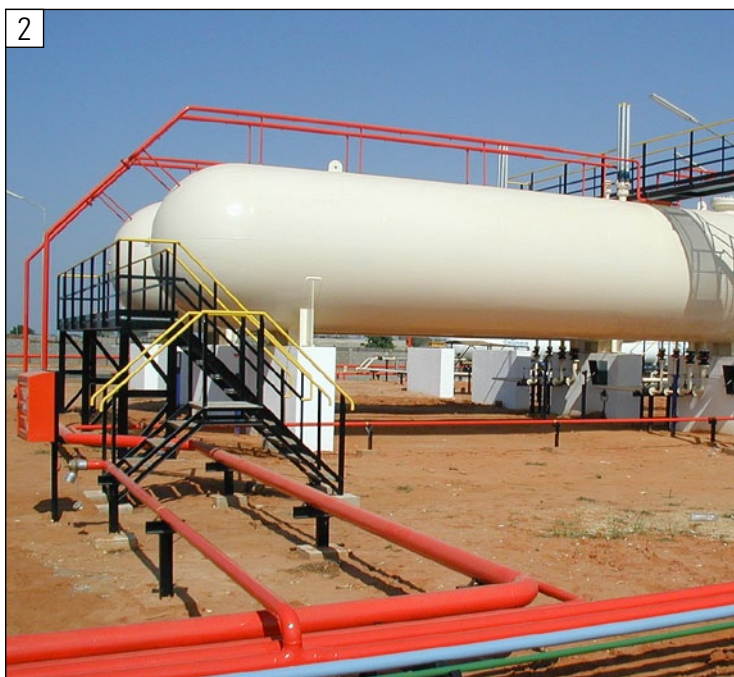
Sistema de agua contra incendios sobre tanques cilíndricos de almacenamiento de GLP
