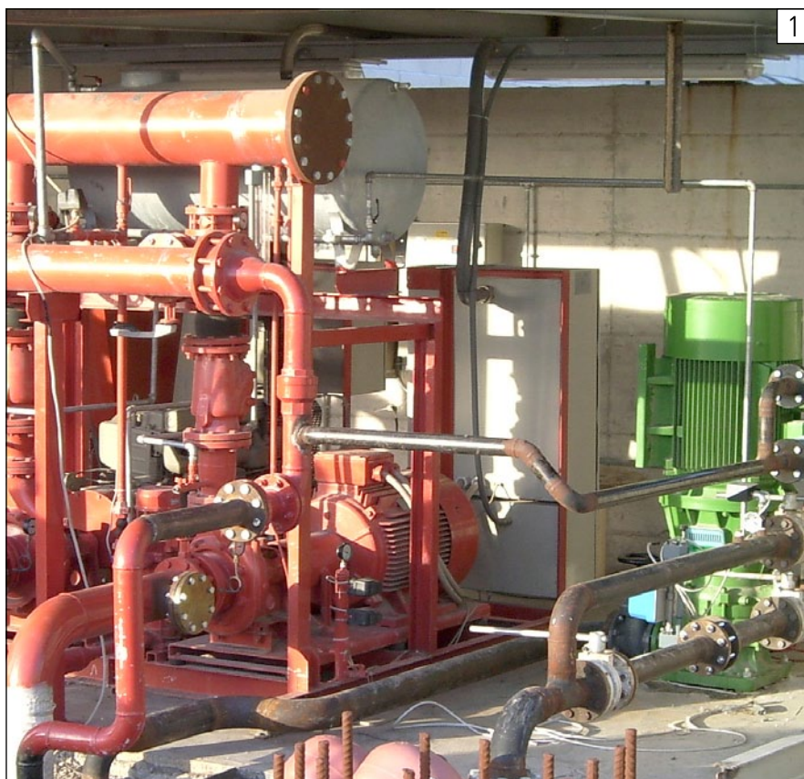
Sistema bomba para agua contra incendios
