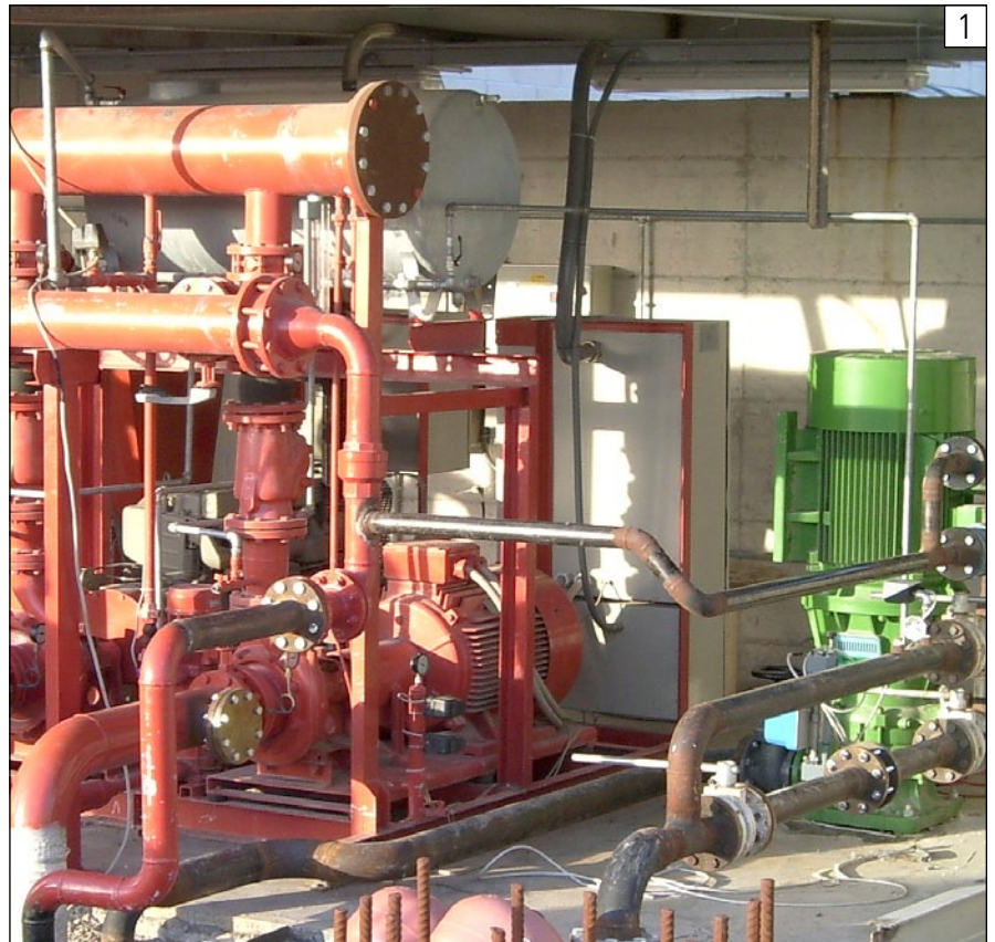
Système de pompe eau incendie
