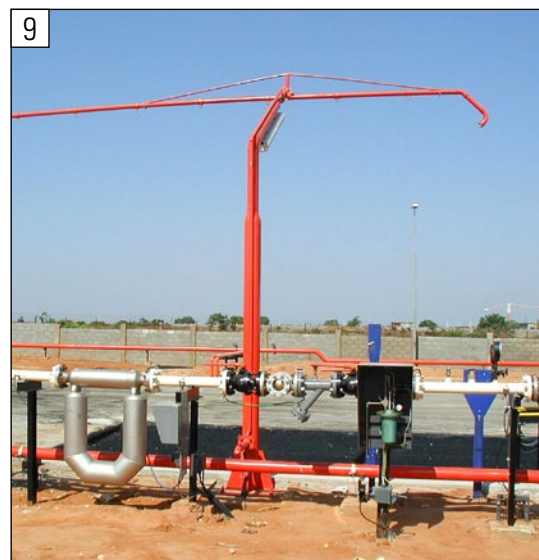
Installation d'extincteurs au point de chargement et de déchargement pour citernes roulantes
