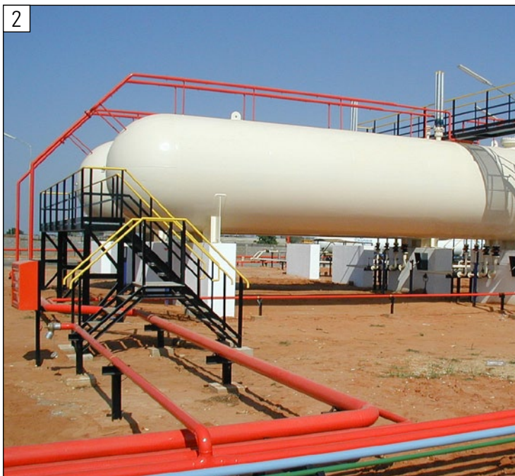
Réseaux eau incendie avec réservoir de stockage cylindrique GPL
