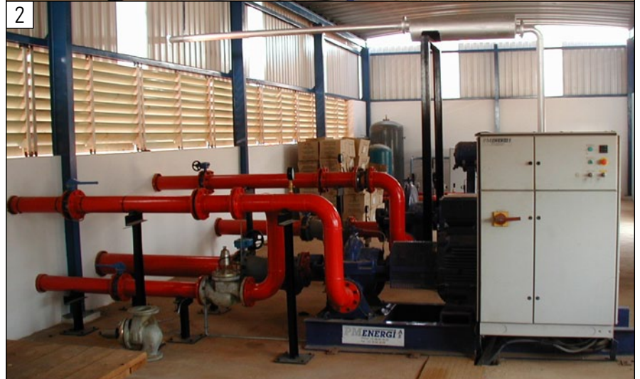
Installation électrique (en zone non dangereuse) pour système de pompe eau incendie
