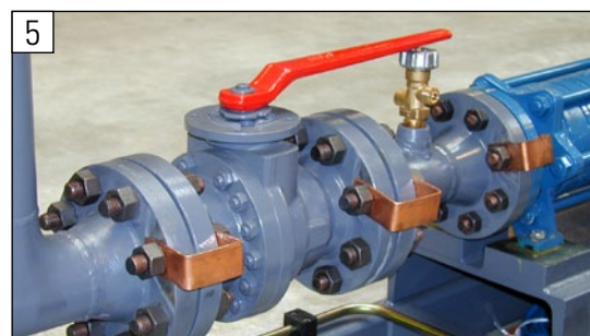
Détails de tuyauterie: robinet de fermeture, robinet de sécurité et mises à la terre
